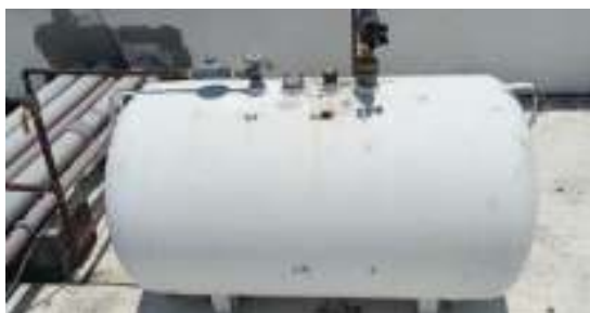
FOTOGRAFÍA 7. TANQUE ESTACIONARIO DE GAS LP PARA EL ÁREA DE SECADO DE SÁBANAS
