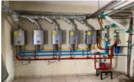
FOTOGRAFÍA 11. CALENTADORES INSTANTÁNEOS MODULANTES INSTALADOS EN EL MOTEL D'LUXE
