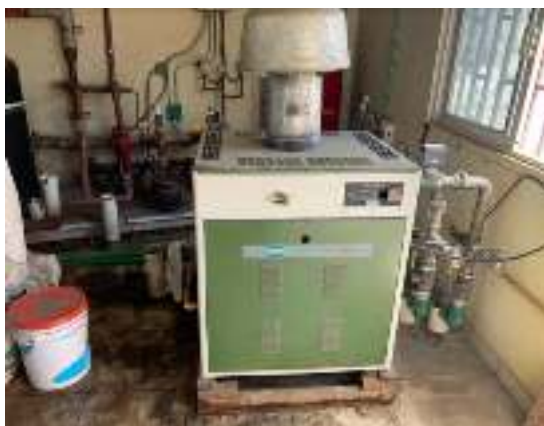
FOTOGRAFÍA 5. EQUIPO DE CALENTAMIENTO DE AGUA
