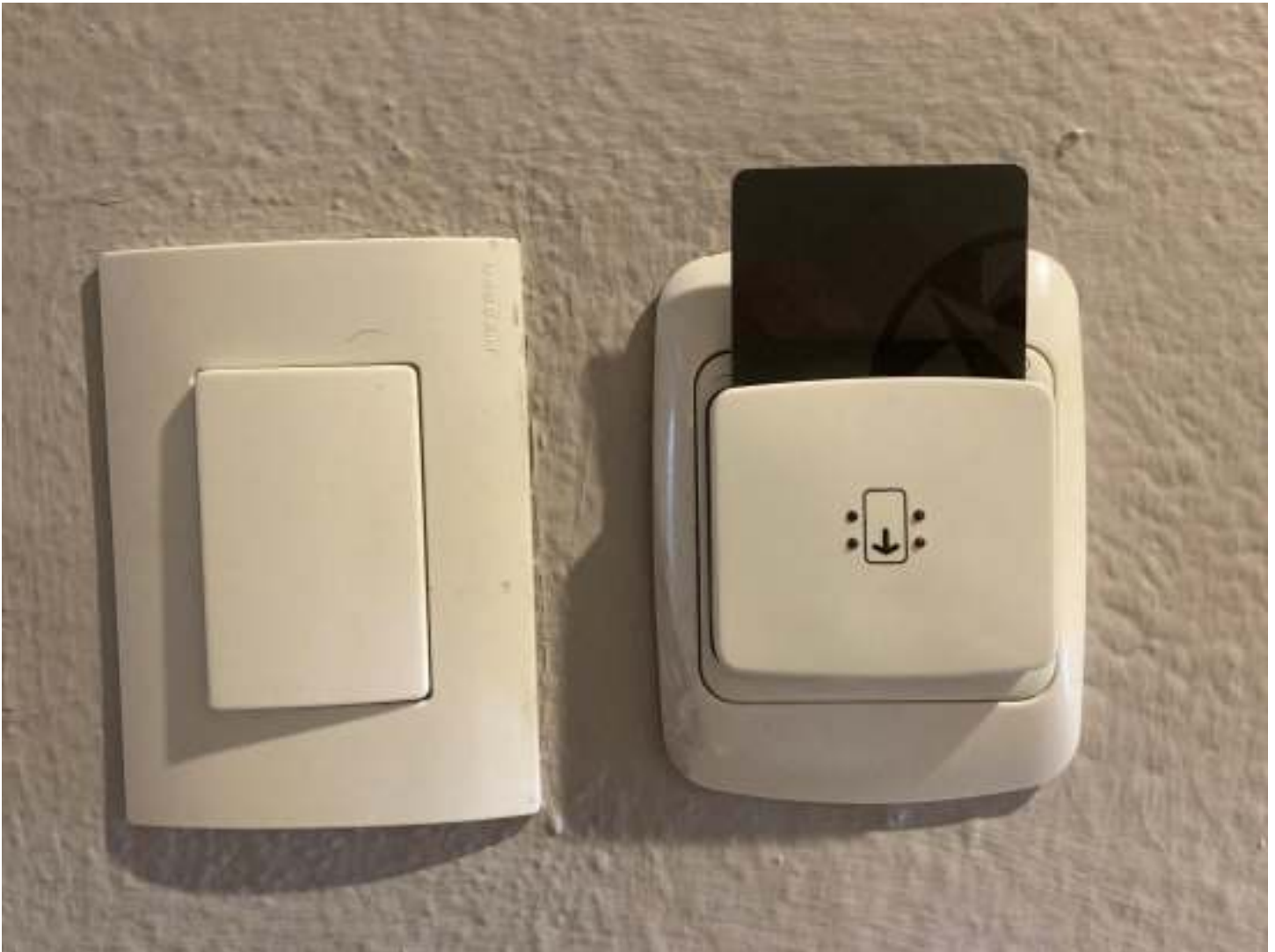
Interruptor de tarjeta en hotel.
